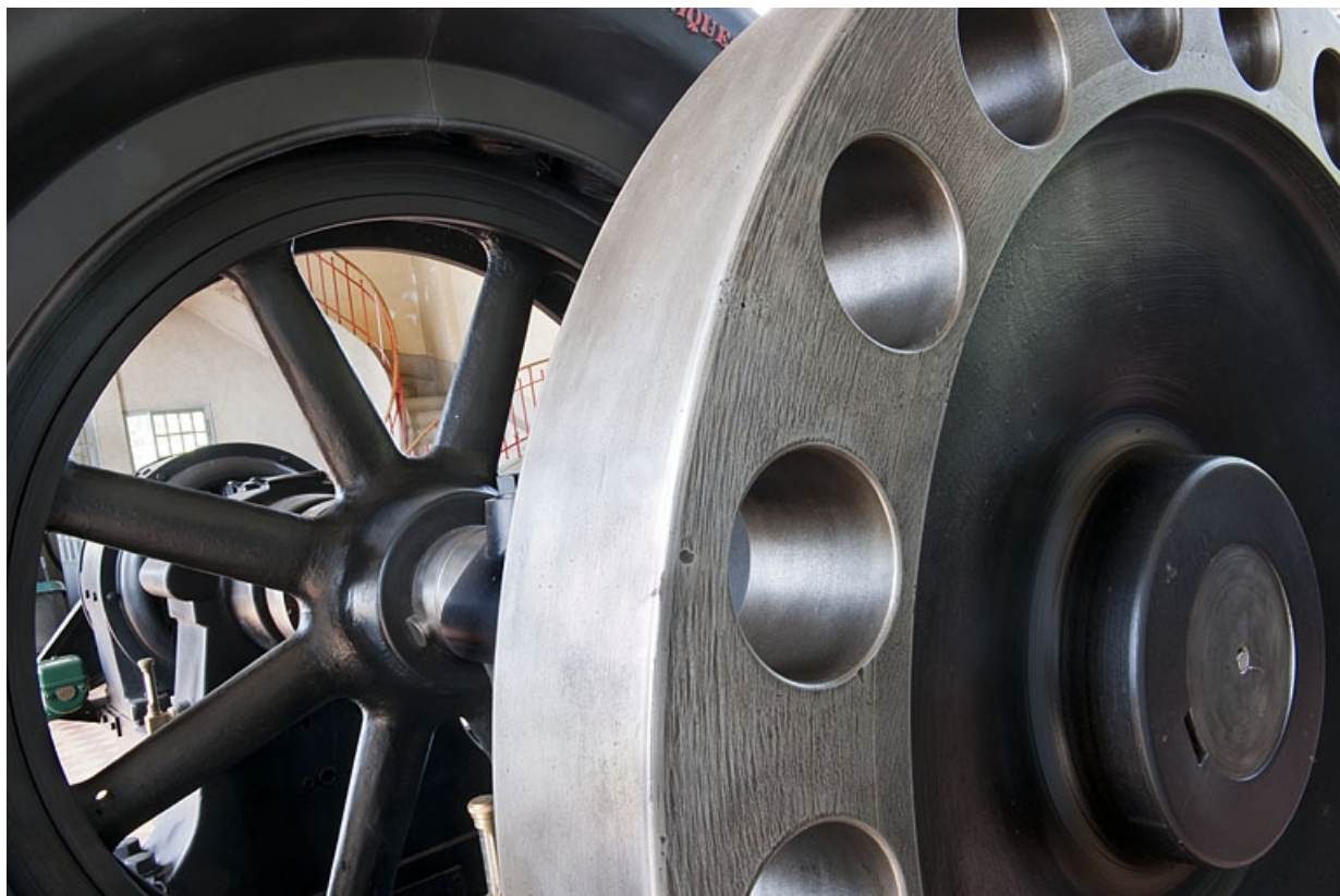
Détail de l'alternateur de la Société Alsacienne de Constructions Mécaniques (Belfort). 25, Mathay, lieudit : rue du Barrage
