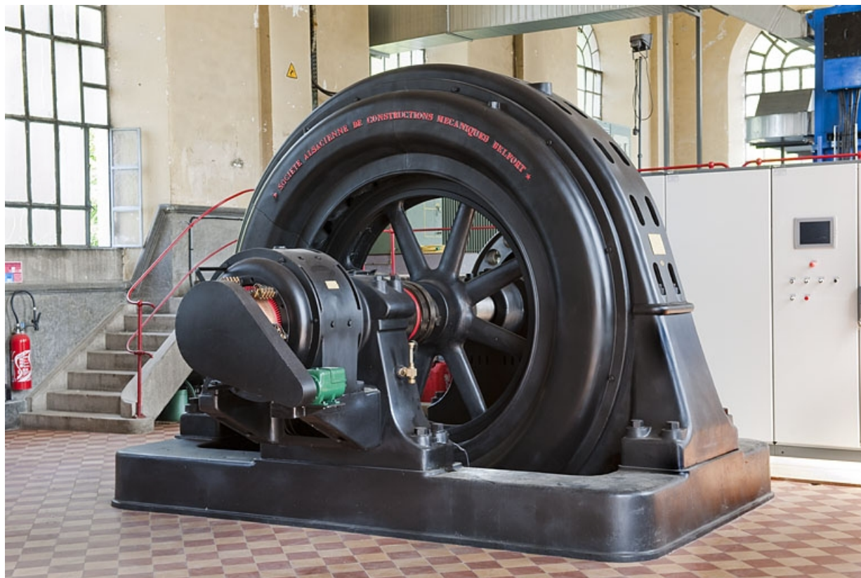
Alternateur de la Société Alsacienne de Constructions Mécaniques (Belfort). 25, Mathay, lieudit : rue du Barrage
