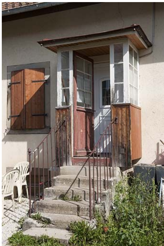
Façade postérieure d'une maison individuelle rue des Lesses. Détail de l'escalier du jardin. 25, Valentigney, 1 à 67 rue des Cités
