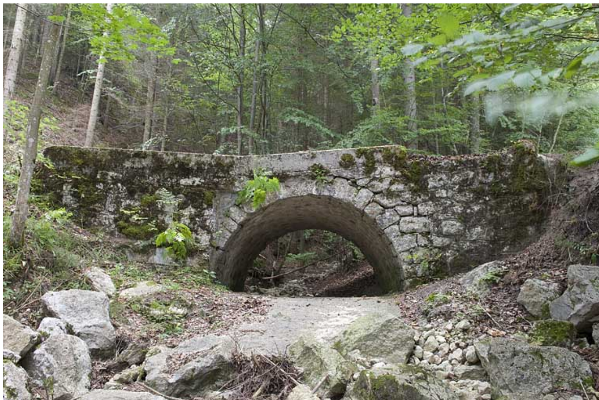
Pont sur le ruisseau de la Grange des Pauvres (n°7), vue depuis l'aval. 25, Jougne
