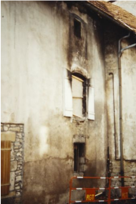
Bâtiment rue Basse : vue rapprochée de l'élévation depuis la rue, après l'incendie. S.d. [vers 2000]. 25, Rougemont, 6, 8 rue Basse
