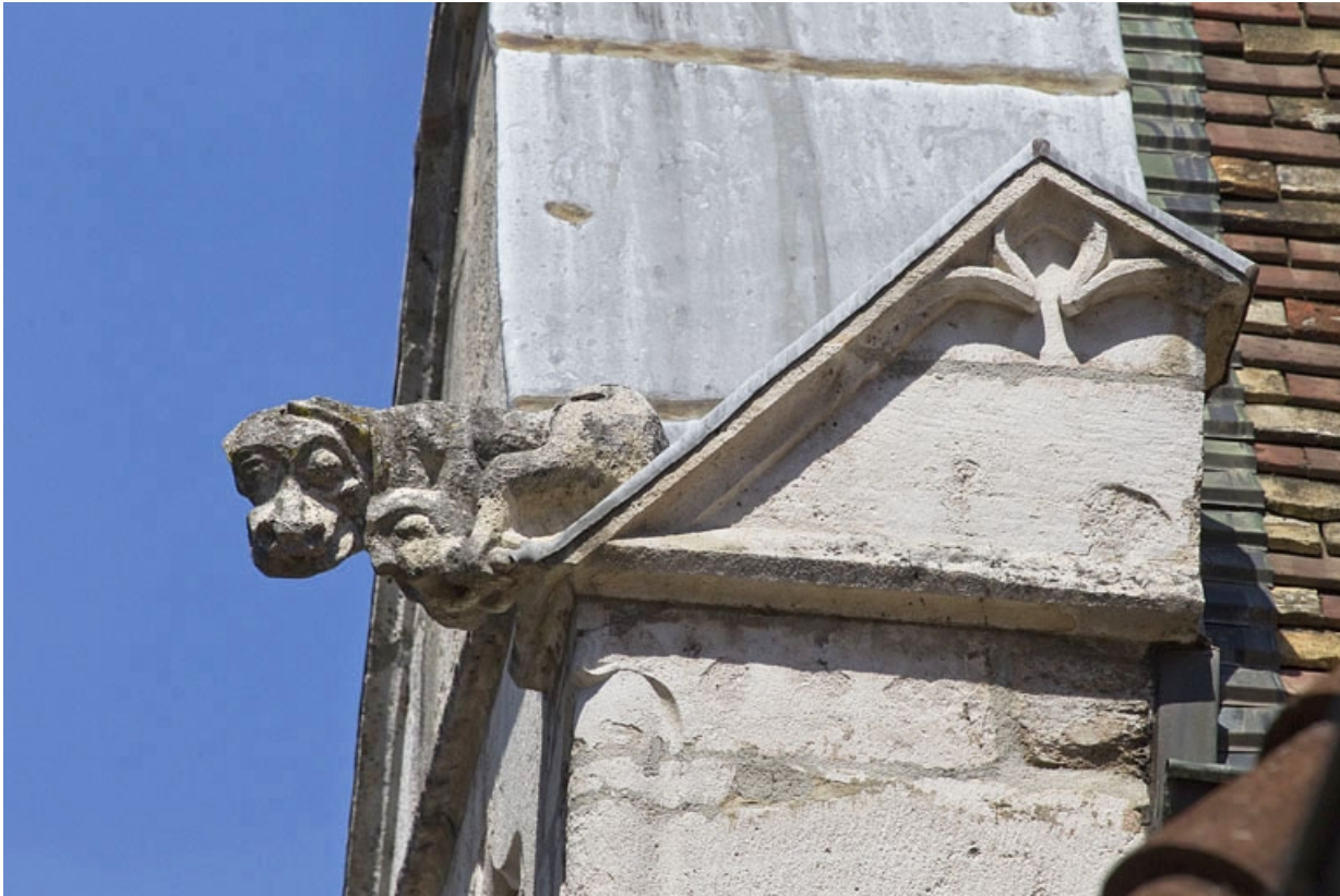
Façade antérieure, lucarne : détail d'une gargouille. 25, Besançon, 19 rue Rivotte, lieudit : îlot Porte Rivotte
