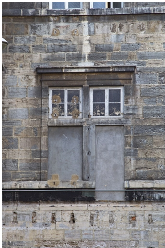
Façade postérieure, tour droite : détail d'une fenêtre du premier étage. 25, Besançon, 12 rue de l' Orme de Chamars, lieudit : îlot Saint-Jacques
