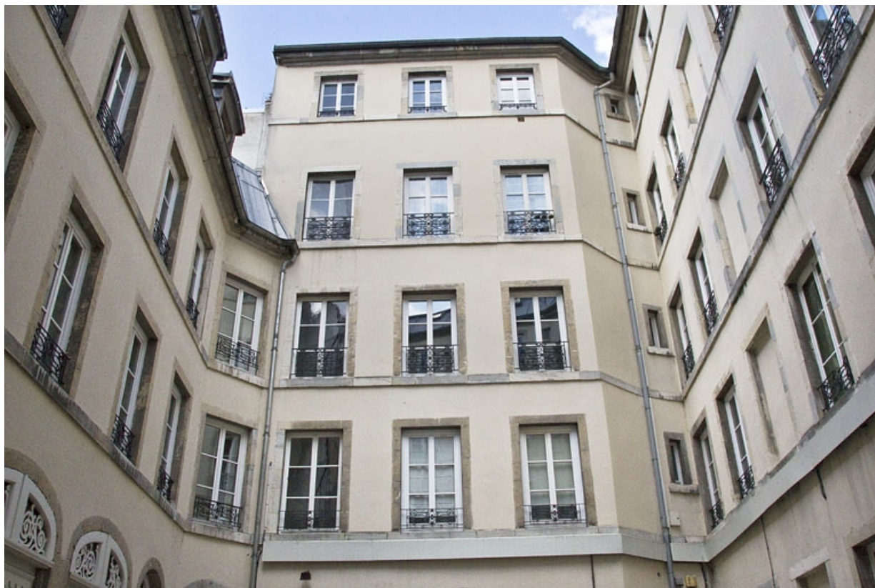
Vue d'ensemble des façades sur cour depuis l'entrée située côté rue Morand. 25, Besançon, 15 rue Proudhon, lieudit : îlot Morand
