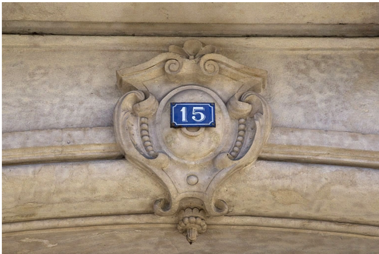
Logis principal, façade antérieure, portail d'entrée côté rue Proudhon : détail de la clé de l'arc. 25, Besançon, 15 rue Proudhon, lieudit : îlot Morand
