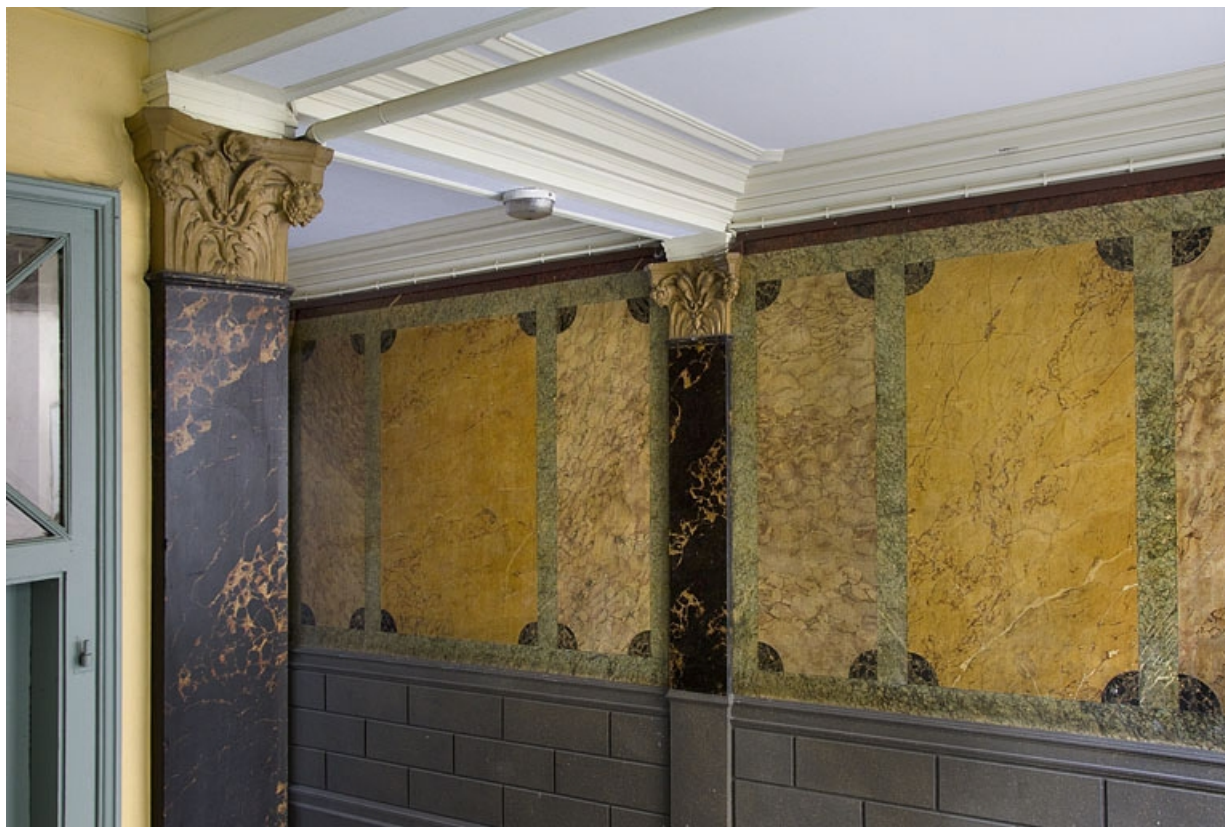
Logis principal, passage cocher côté rue Proudhon : détail du décor en faux marbre. 25, Besançon, 15 rue Proudhon, lieudit : îlot Morand
