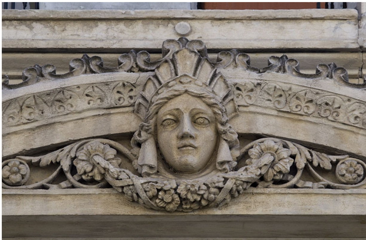
Façade antérieure, premier étage : détail rapproché du décor de la fenêtre centrale.
