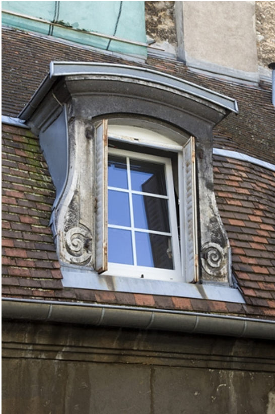
Première cour, logis principal : détail d'une lucarne, aile à droite de la cour. 25, Besançon, 17 rue des Granges, lieudit : îlot Poste
