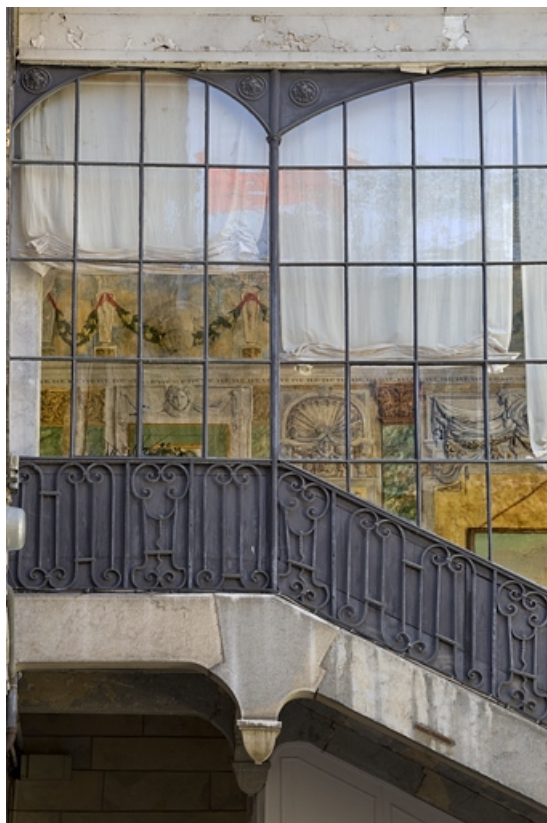
Escalier à cage ouverte, détail du décor peint depuis l'extérieur : de face.
