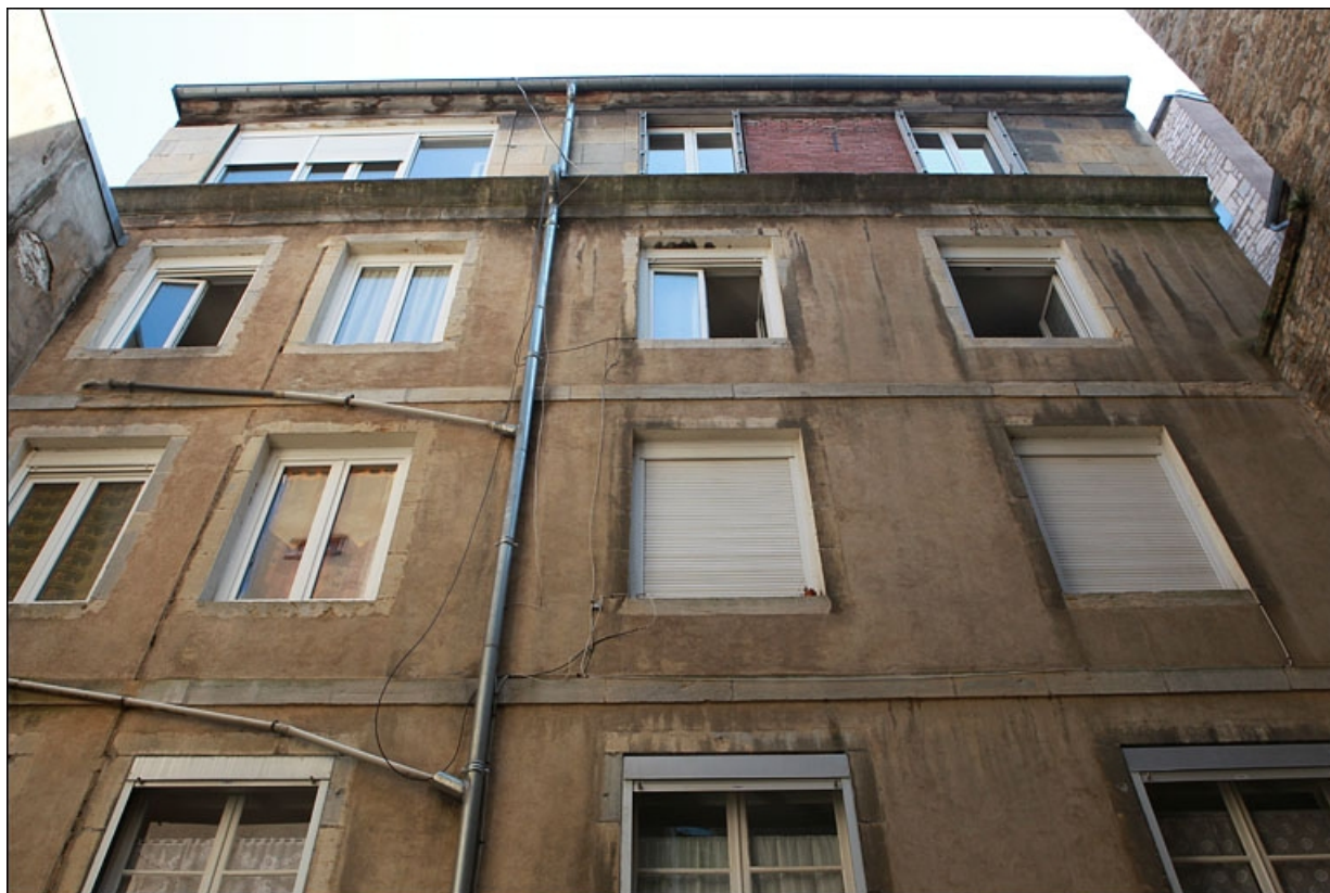
Deuxième cour : façade antérieure du deuxième logis secondaire, vue des étages. 25, Besançon Grande Rue 79, lieudit : îlot Saint-Pierre
