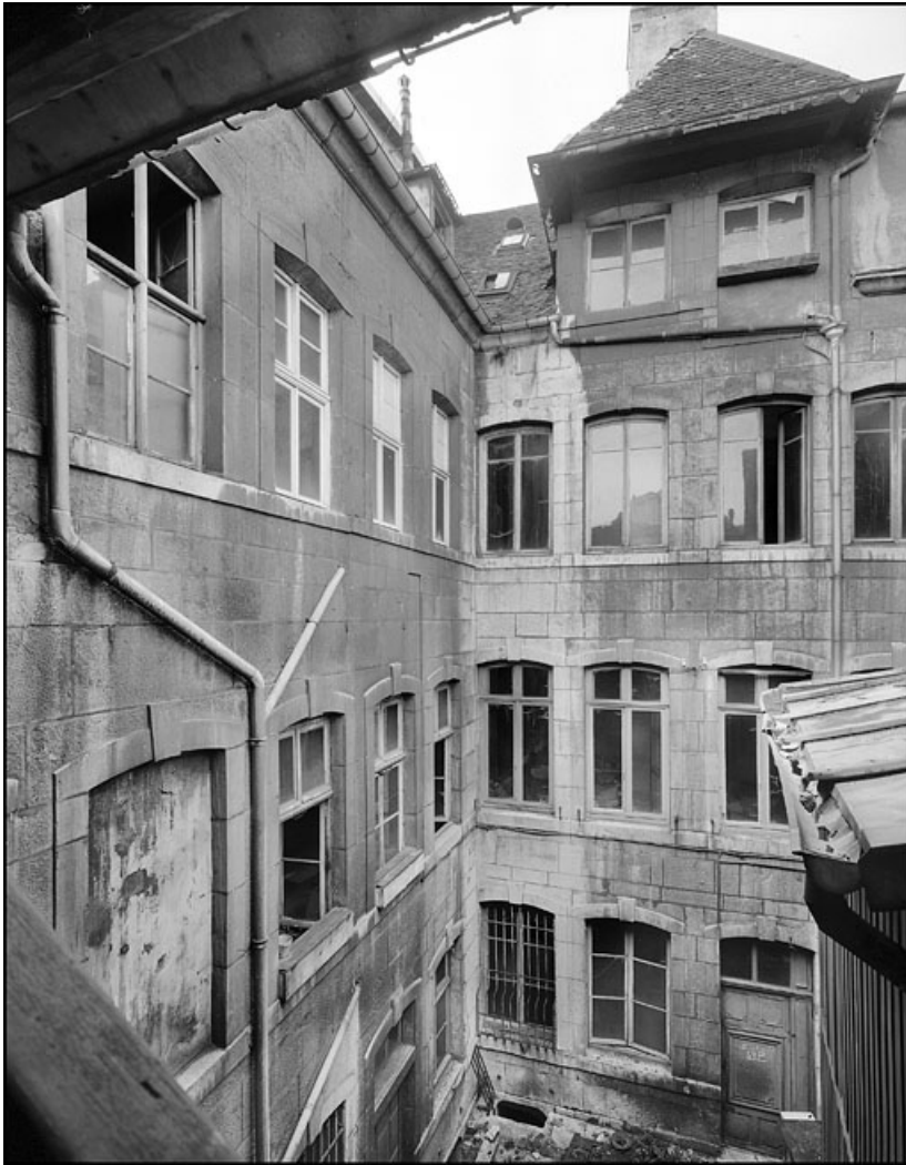
Vue d'ensemble des bâtiments détruits depuis le fond de la deuxième cour, de trois quarts droit. 25, Besançon Grande Rue 67, lieudit : îlot Saint-Pierre
