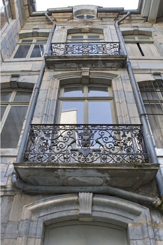
Façade antérieure en fond de cour : détail des balcon de la travée centrale. 25, Besançon Grande Rue 67, lieudit : îlot Saint-Pierre
