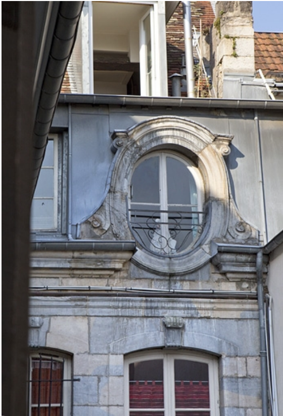
Façade antérieure du logis en fond de cour : détail de la lucarne centrale. 25, Besançon Grande Rue 67, lieudit : îlot Saint-Pierre
