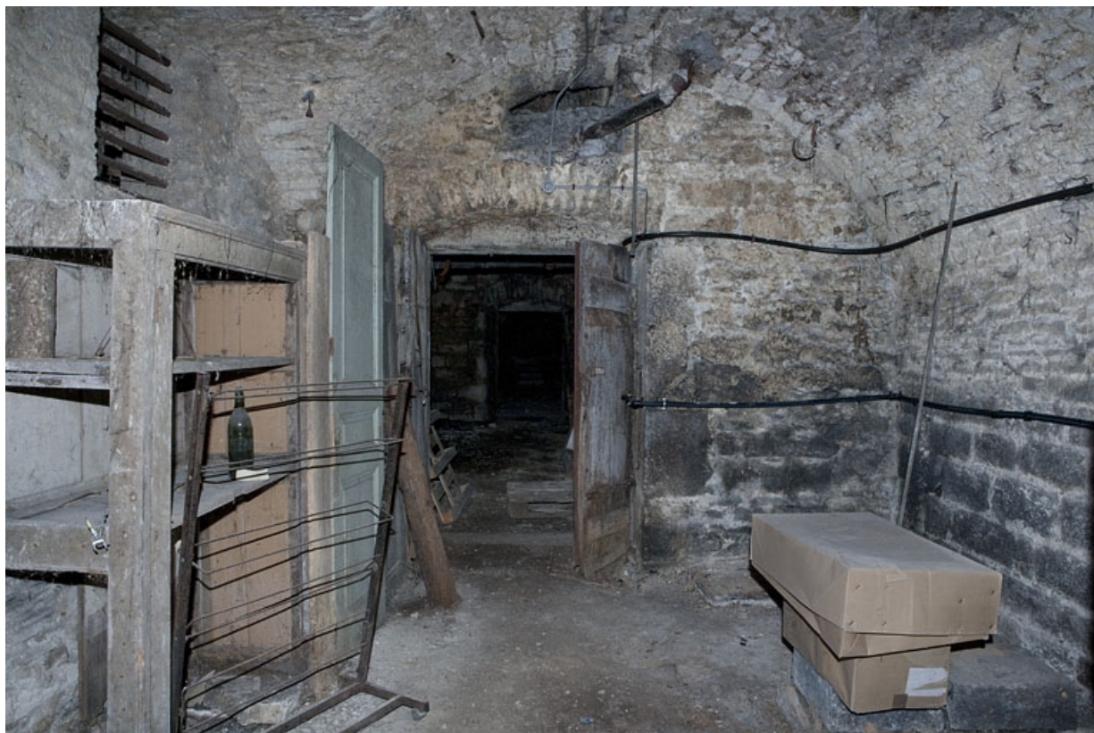
Logis principal, sous-sol : cave A, vue en direction de la porte d'entrée.
