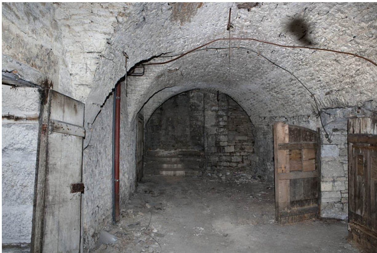
Logis principal, sous-sol : cave C, partie droite depuis le fond. 25, Besançon Grande Rue 53, lieudit : îlot Bouteiller
