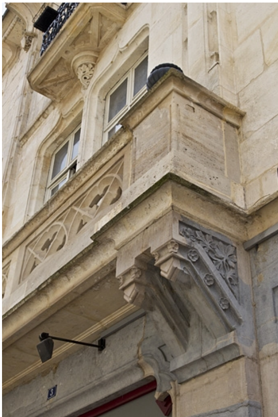
Logis secondaire, façade antérieure, balcon du premier étage, détail du support droit. 25, Besançon, 1, 3 rue d' Anvers, lieudit : îlot d' Emskerque
