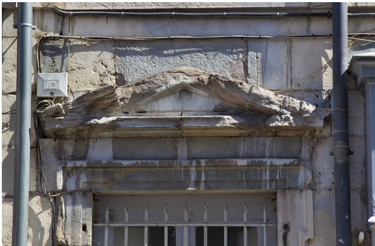
Logis principal, façade antérieure : détail du fronton de la fenêtre à gauche du portail d'entrée.
