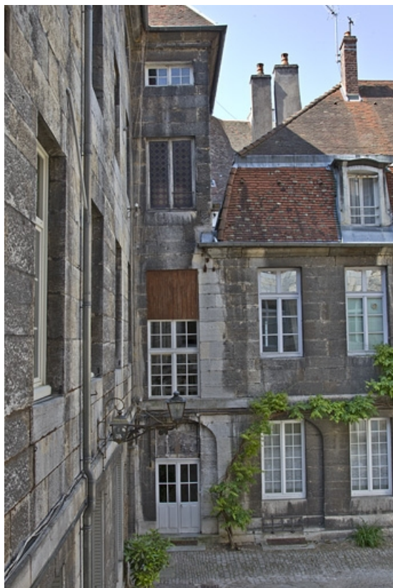
Logis principal, aile gauche sur cour contenant une partie de l'escalier dans oeuvre. 25, Besançon, 28 rue de la Préfecture, lieudit : îlot Mairie
