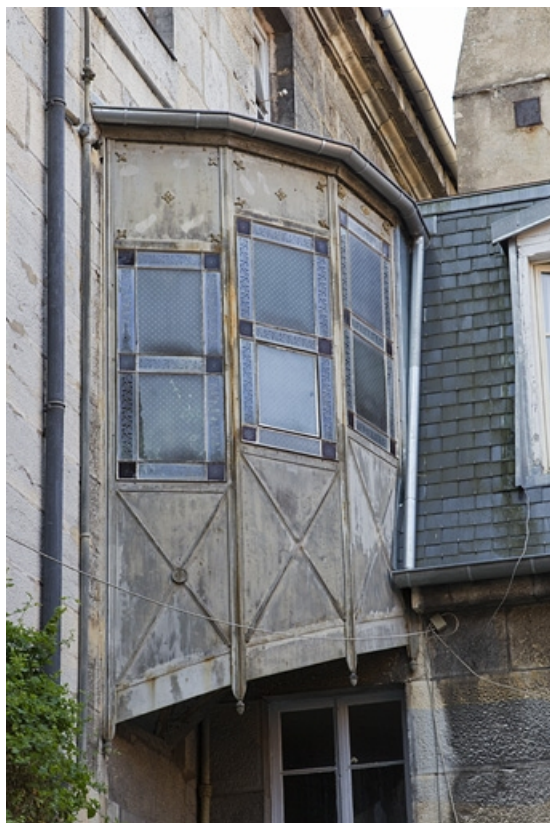
Vue du passage suspendu entre le logis principal et l'aile gauche des communs. 25, Besançon, 22 rue de la Préfecture, lieudit : îlot Mairie
