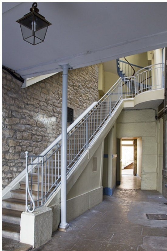
Logis principal : vue d'ensemble de l'escalier. 25, Besançon, 3 rue Lecourbe, lieudit : îlot Refuge
