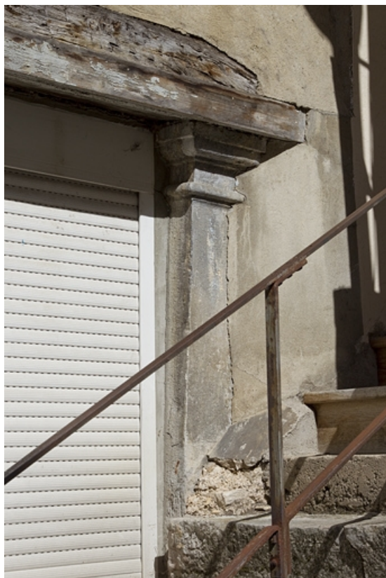
Façade postérieure du premier logis secondaire, vestiges supposés d'un portique : détail d'un chapiteau toscan. 25, Besançon, 37 rue Renan, lieudit : îlot Cingle
