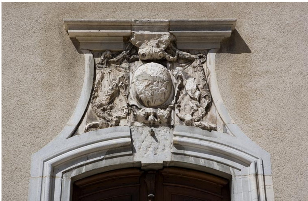
Détail des armoiries bûchées sur la porte d'entrée du logis.
