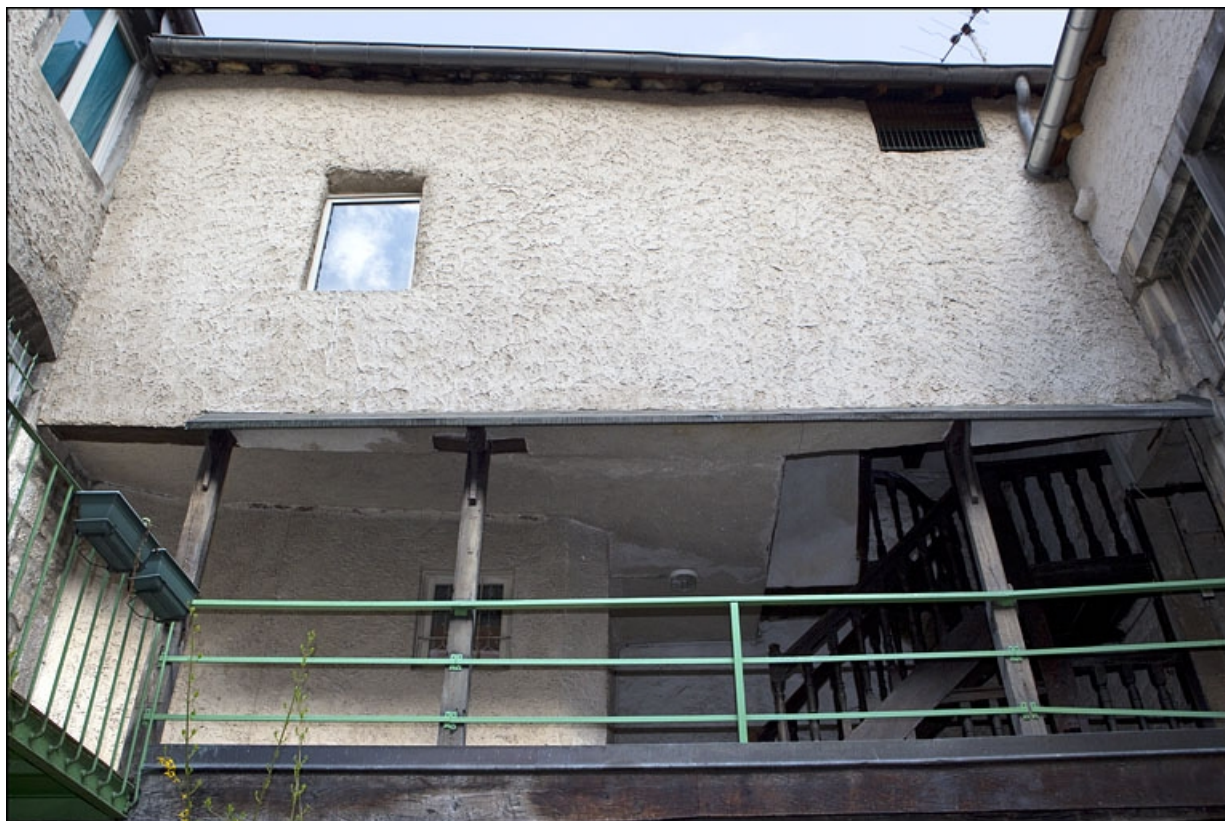
Escalier à cage ouverte : détail de la coursière desservant le premier étage du logis secondaire, face depuis la cour. 25, Besançon, 28 rue Rivotte, lieudit : îlot Boitouset
