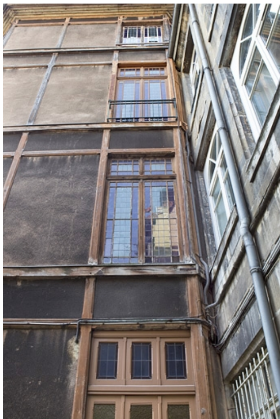
Détail de la paroi de la cage d'escalier en pan de bois. 25, Besançon, 133 Grande Rue, lieudit : îlot Saint-Maurice
