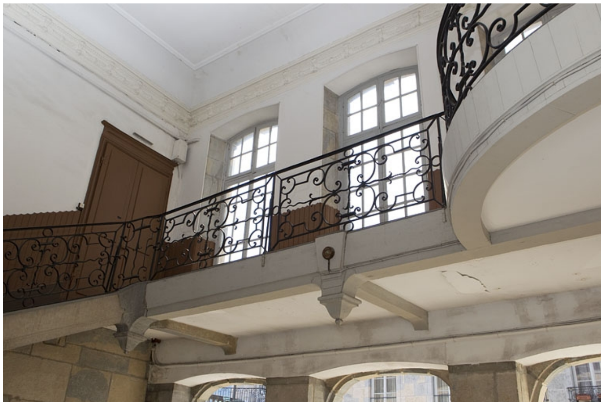
Aile droite, escalier : premier étage, vue de la grille en ferronnerie du palier.
