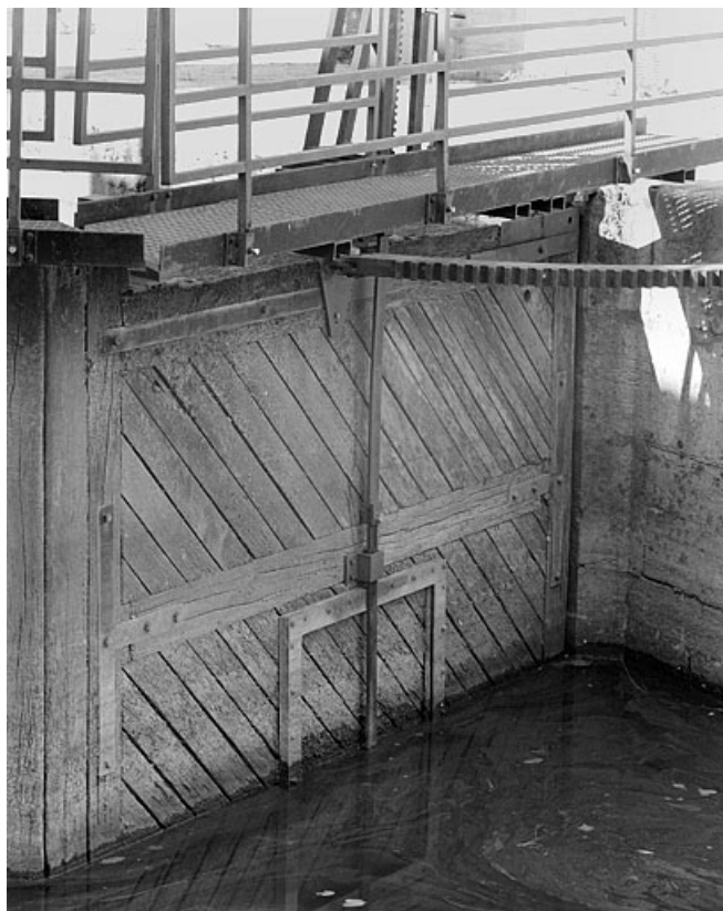
Porte amont droite : tige de manoeuvre et guide de la vantelle. 25, Besançon avenue Arthur Gaulard, lieudit : îlot Moulin Saint-Paul
