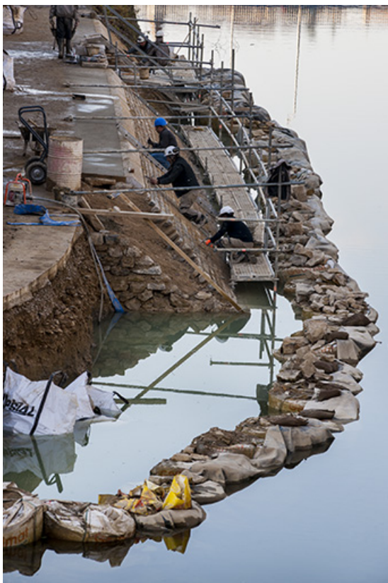
Réfection du perré du chemin de halage en aval du moulin Saint-Paul : coupe du perré. 25, Besançon
