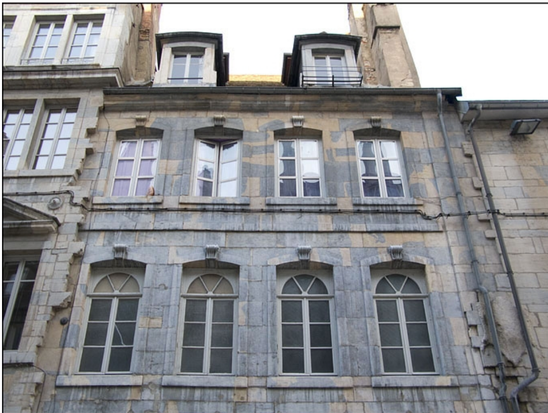
Détail des premier et deuxième étages de la façade antérieure du 13 Grande Rue : de face. 25, Besançon Grande Rue 13, 15, lieudit : îlot Chevanney
