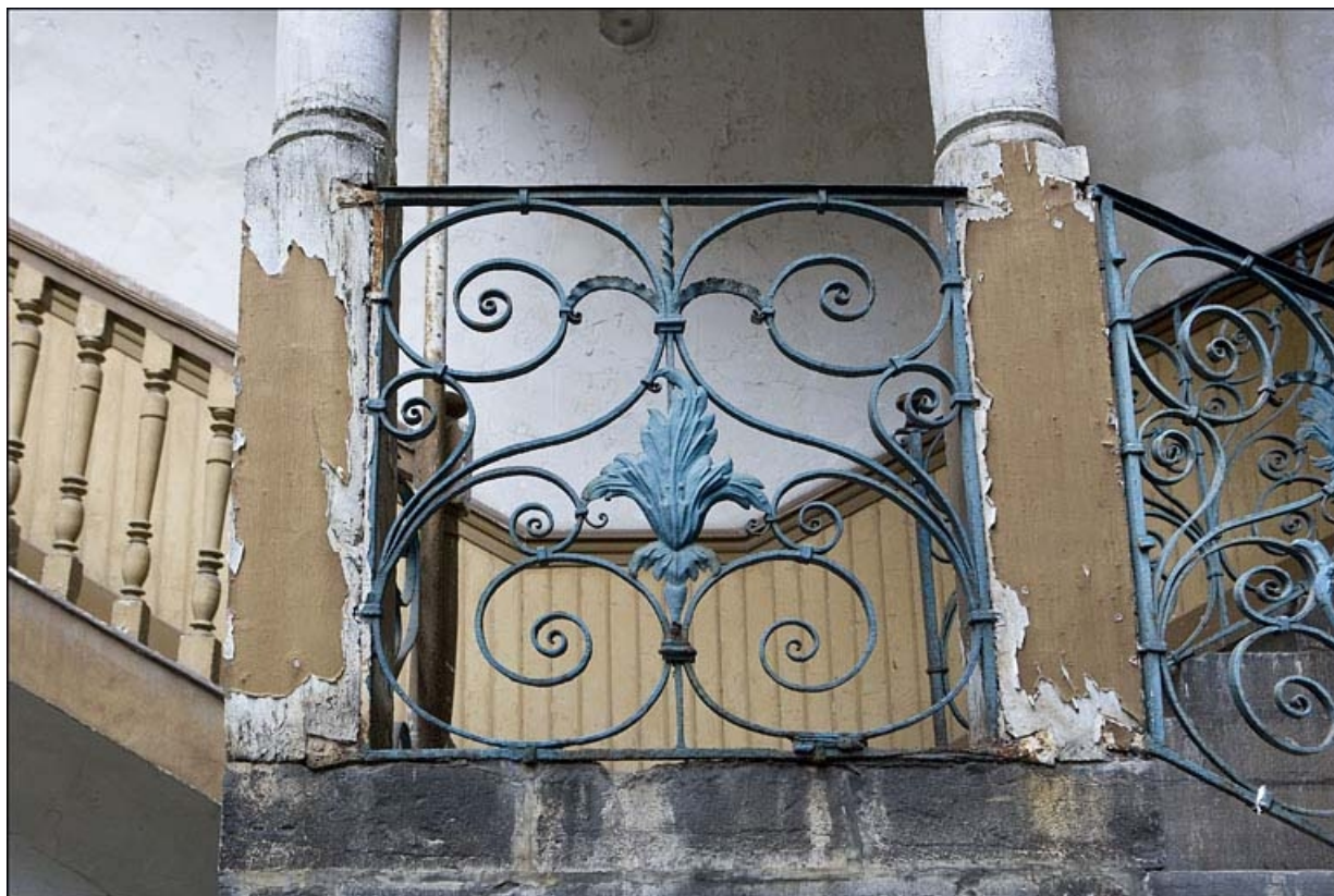
Détail d'une grille en ferronnerie du premier repos de l'escalier à cage ouverte.
