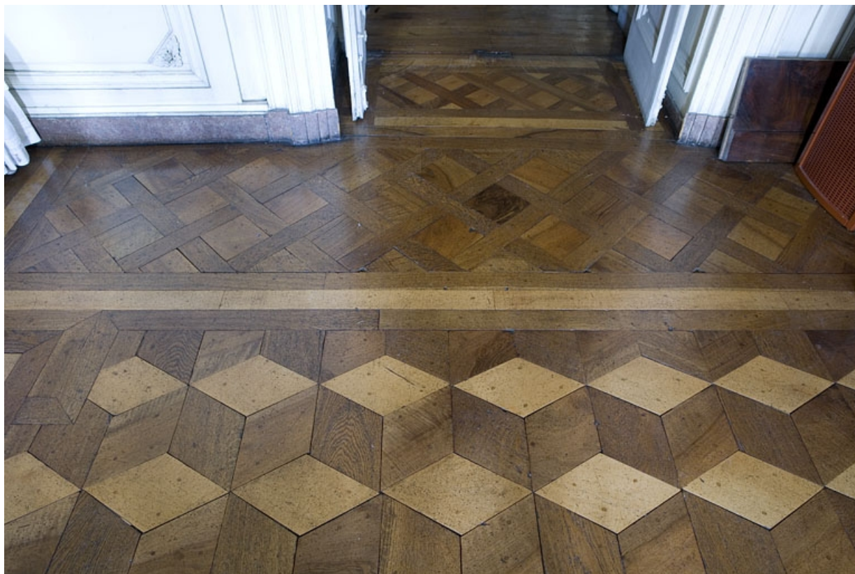
Hôtel en fond de cour : détail du plancher du grand salon vers la porte d'entrée donnant sur l'antichambre. 25, Besançon Grande Rue 104, lieudit : îlot Granvelle
