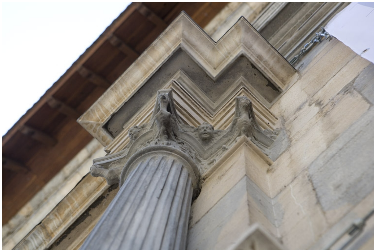
Façade principale : détail du chapiteau d'une colonne encadrant le portail d'entrée, vue rapprochée.
