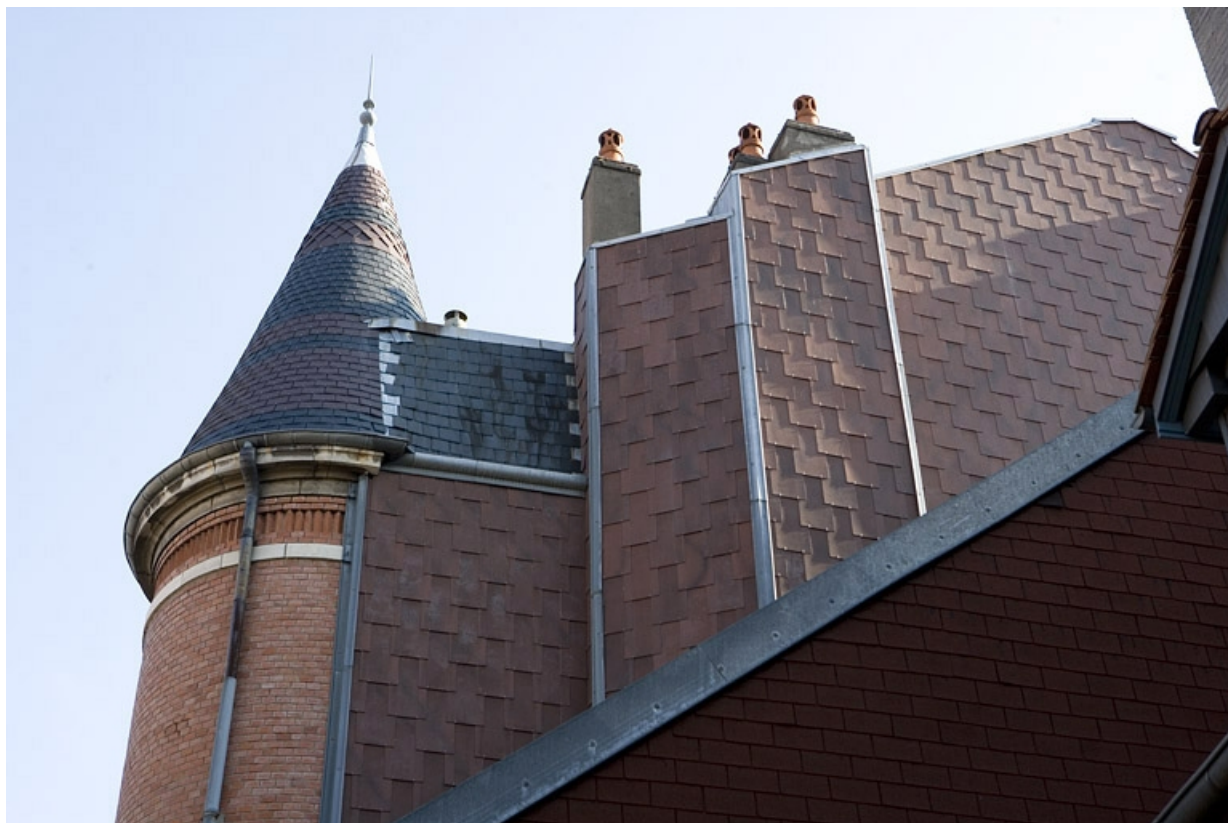
Détail de la partie supérieure de la tour d'escalier au niveau de la toiture du logis principal.
