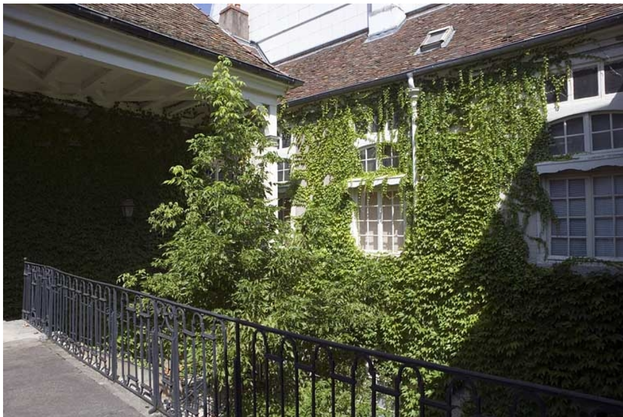
Détail de l'aile en fond de cour depuis le passage au-dessus du portail dans clôture.
