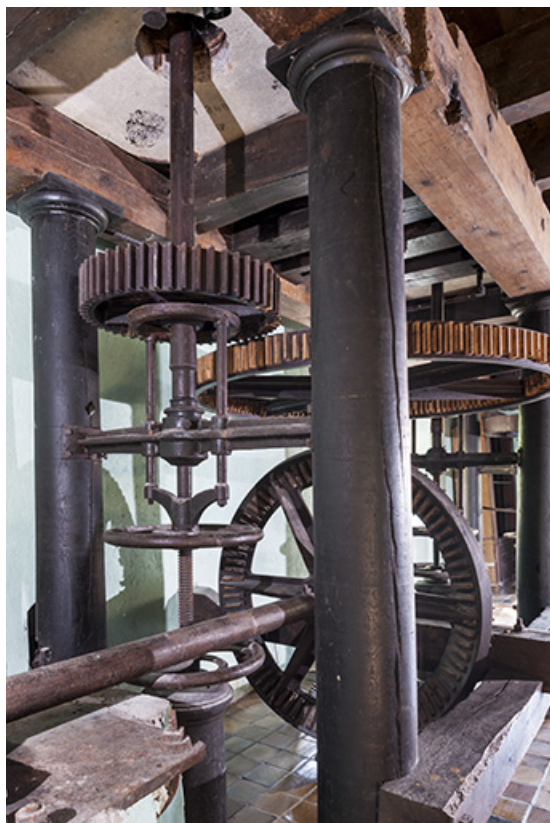
Beffroi est. Détail de la transmission.
