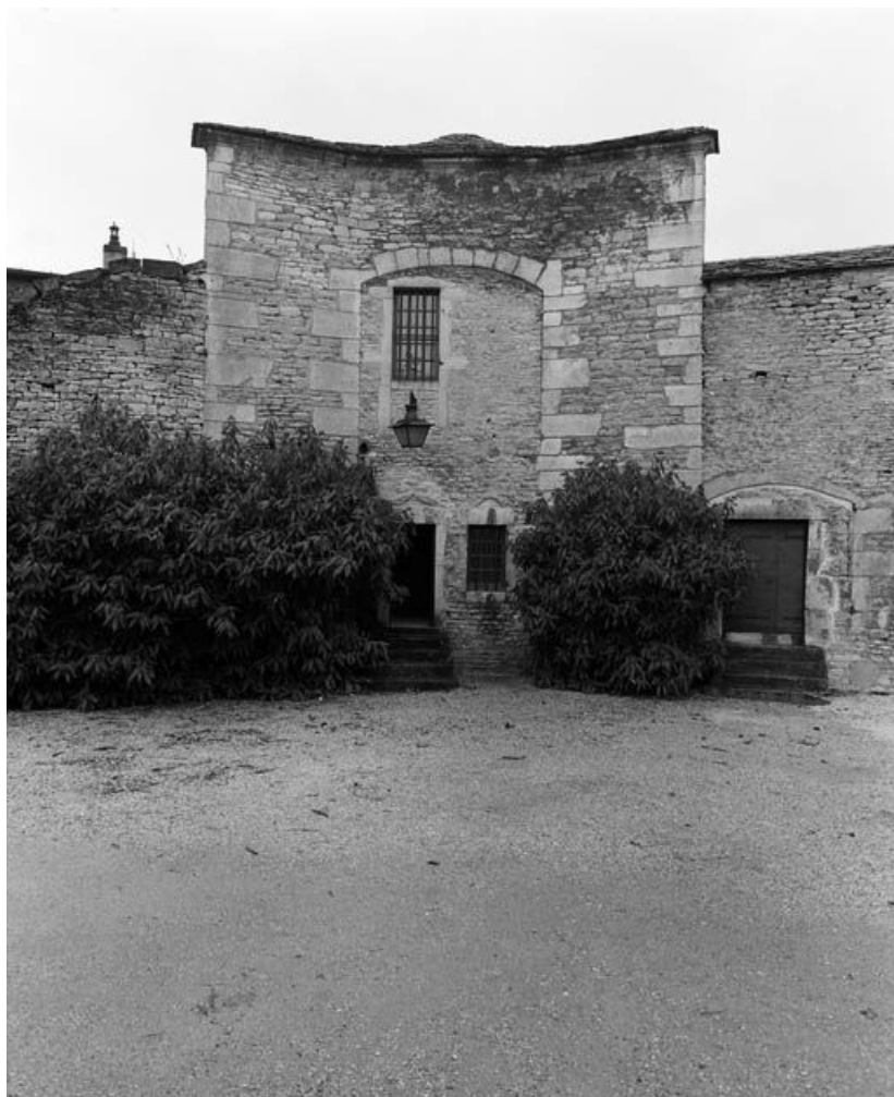
Tour des Cordeliers incluse dans la "grosse tour" (improprement appelée bastion de l'Hôtel-Dieu), depuis le rempart (1992). 21, Beaune boulevard Saint-Jacques
