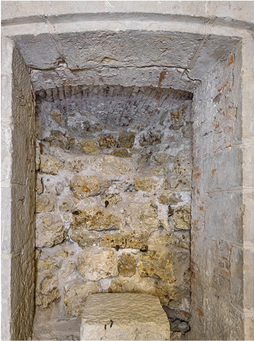
Tour Notre-Dame : ouverture obstruée.
