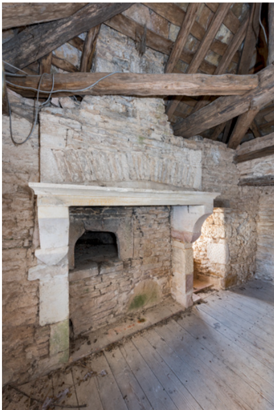
Vue intérieure de la cheminée et de la gueule du four. 21, Salives rue d' Amont
