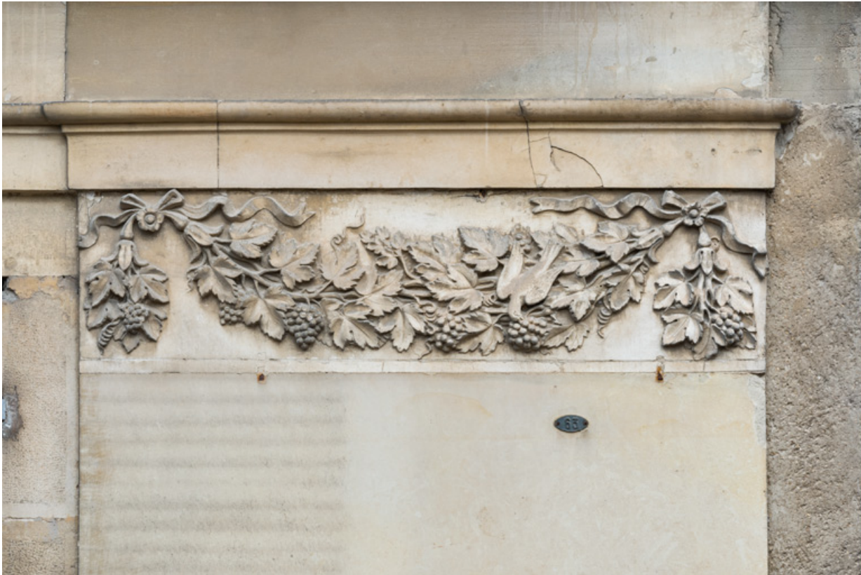
Façade latérale gauche, 4e et dernier pilastre (à droite) : guirlande sculptée et oiseau picorant. 21, Semur-en-Auxois, 11 place de l' Ancienne Comédie
