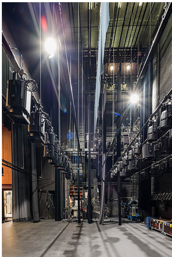
Cage de scène : perches avec projecteurs (vue latérale). 21, Dijon, 9 rue Condorcet
