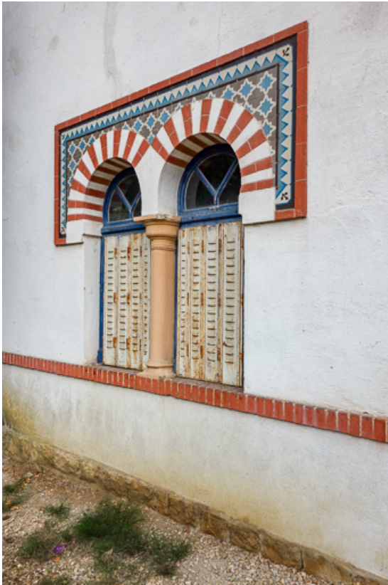
Élévation du pavillon du gardien, baies jumelées du rez-de-chaussée. 21, Santenay avenue des Sources
