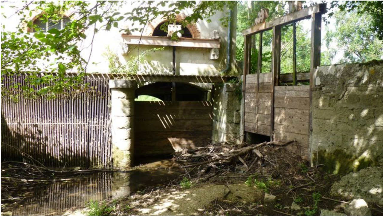
Vue du raccordement du moulin sur le bief.
