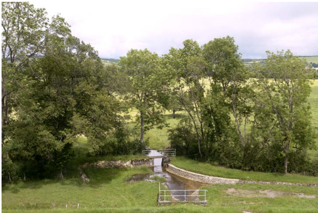
Décharge de fond au centre de la digue principale ; rigole. Jonction des eaux issues de cette décharge de fond et de celles du déversoir.
