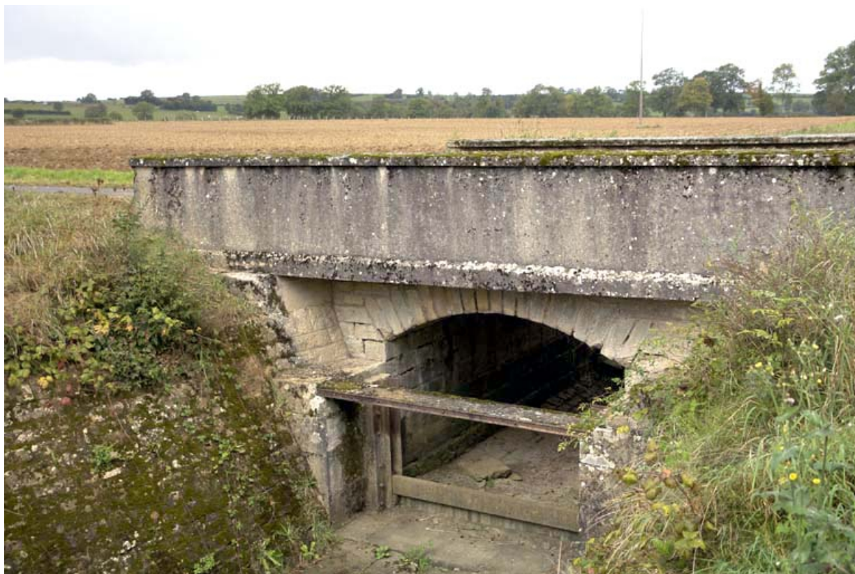
Pont routier sur la rigole de prise d'eau dite "rigole de Beaume", vue amont. 21, Chazilly, lieudit : Chazilly
