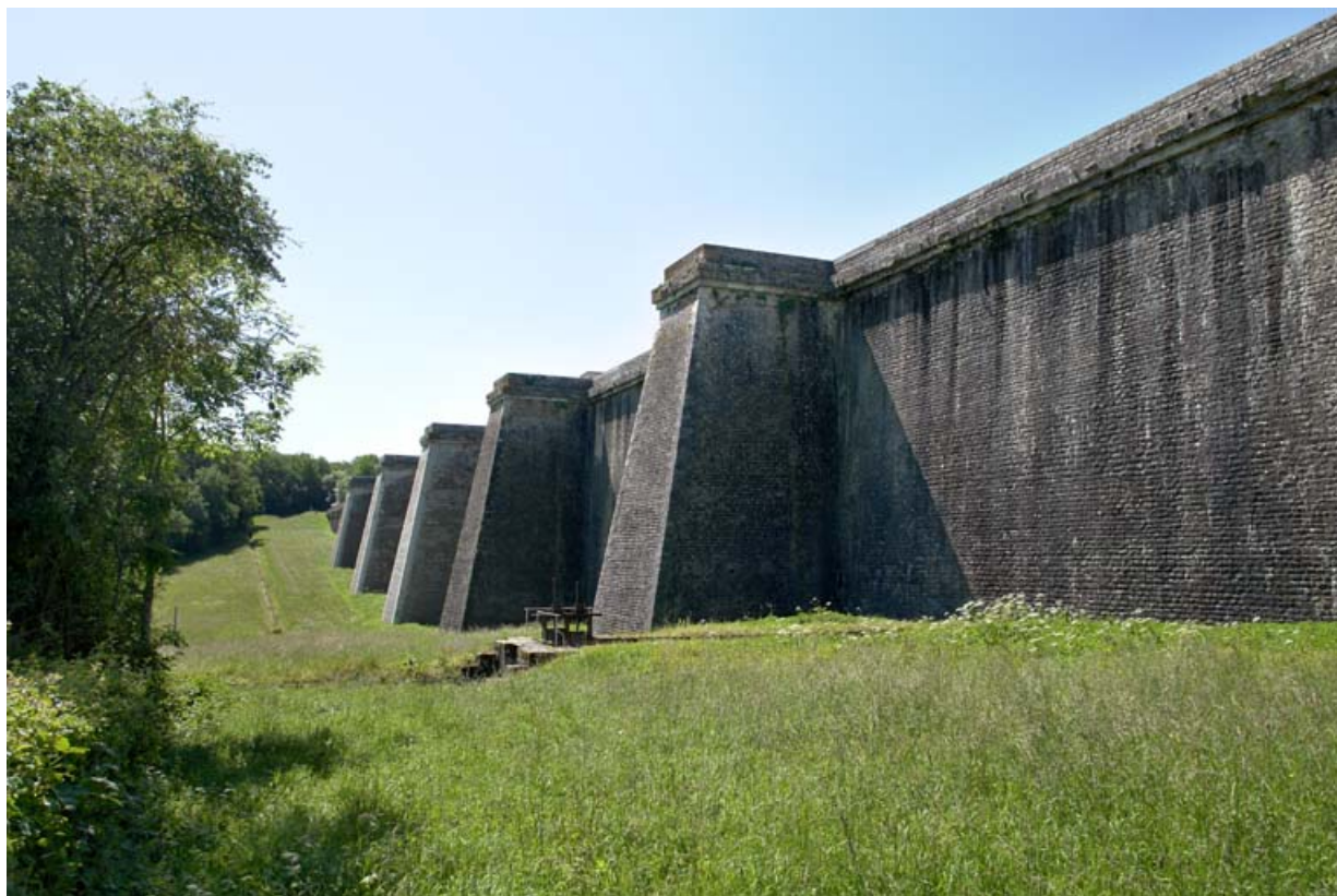
Face avant du barrage, vue de l'extrémité nord. La rigole d'alimentation au premier plan.
