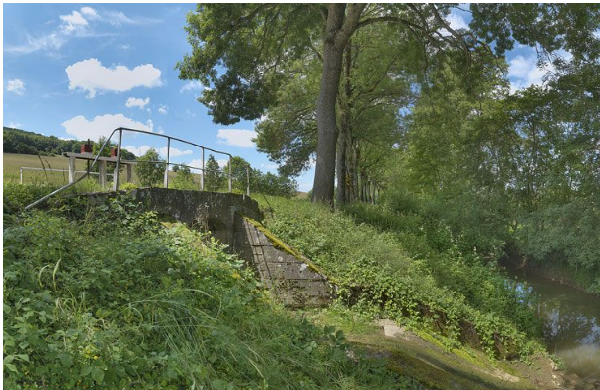
Vannes et garde-corps du déversoir de la rive gauche : sortie de l'eau.
