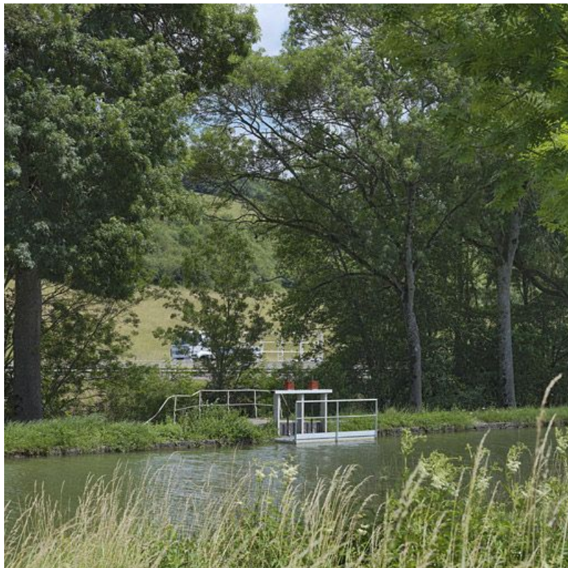
Vannes et garde-corps du déversoir vus de la rive droite. Autoroute en arrière-plan.
