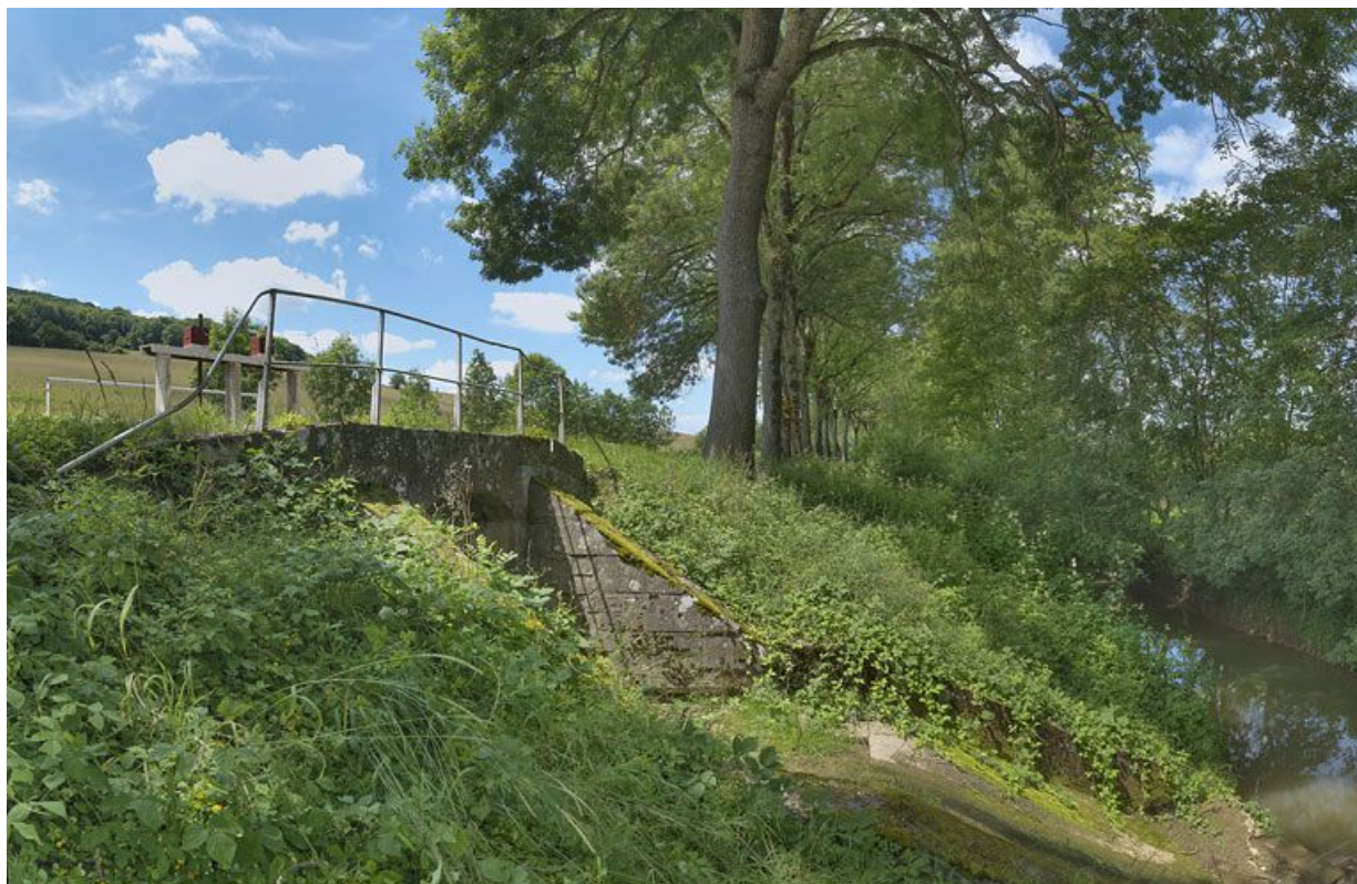
Vannes et garde-corps du déversoir de la rive gauche : sortie de l'eau.
