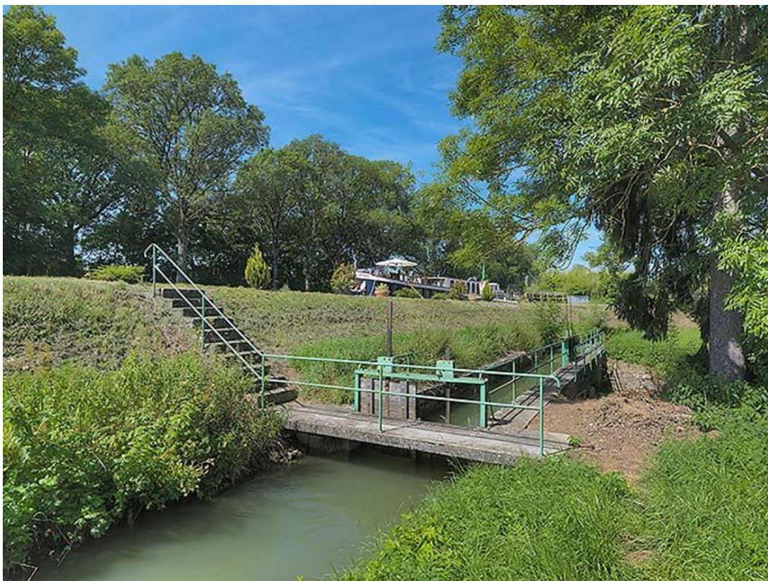
La rigole avec les vannes de régulation. A gauche, le talus du canal.
