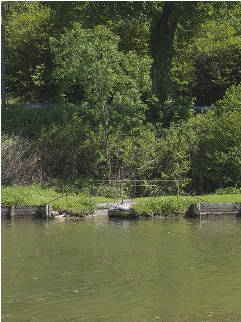
Rive droite : arrivée de la rigole d'alimentation plus en aval dans le bief. 21, Veuvev-sur-Ouche, lieudit : bief 21 du versant Saône
