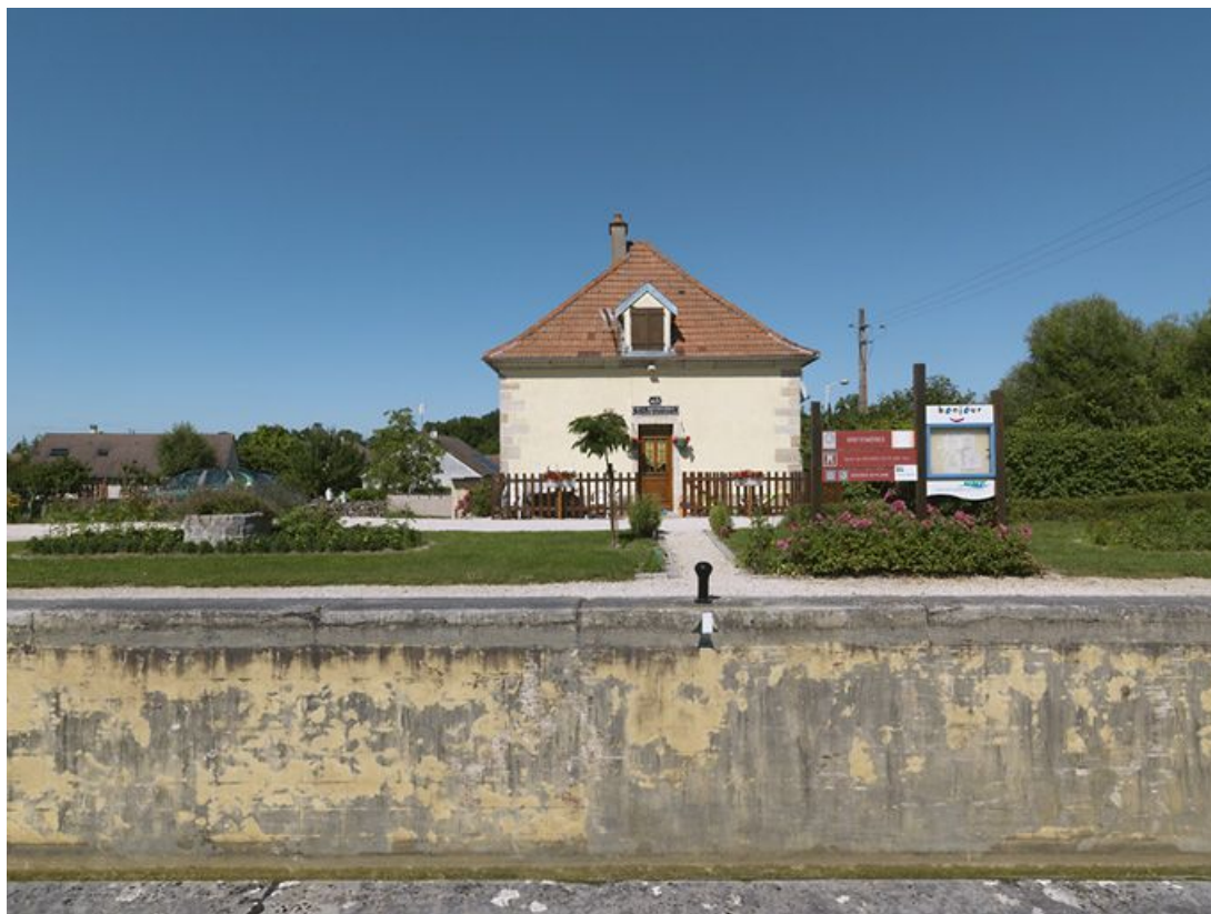
Vue de face de la maison éclusière. Les ouvertures ont été bouchées.
