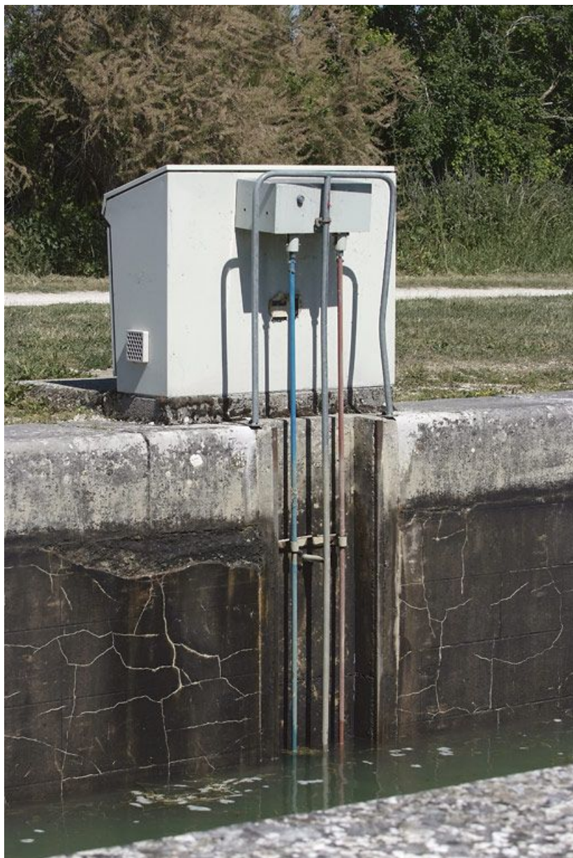
Détail d'un élément du système d'automatisation de l'écluse : la table de commande placée sur le bord du sas. 21, Ouges, lieudit : bief 63 du versant Saône
