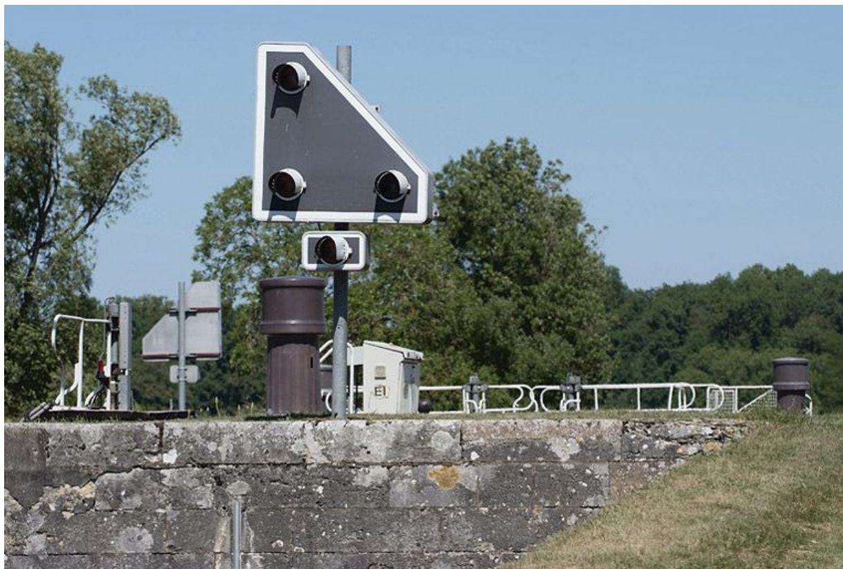
Détail du système d'automatisation de l'écluse : les feux de signalisation.
