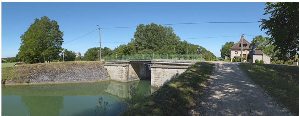
Le pont vu d'aval. Son rehaussement se lit nettement dans le décrochement de maçonnerie des piles.
