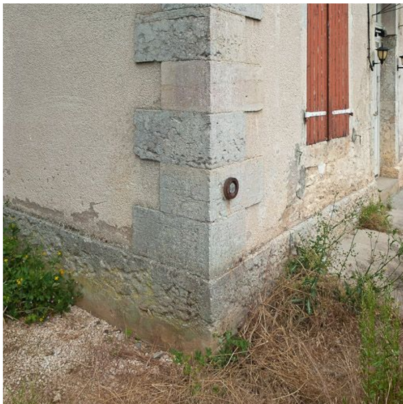
Détail des matériaux de la maison éclusière : chaîne d'angle et soubassement. 21, Fleurey-sur-Ouche, lieudit : bief 42 du versant Saône
