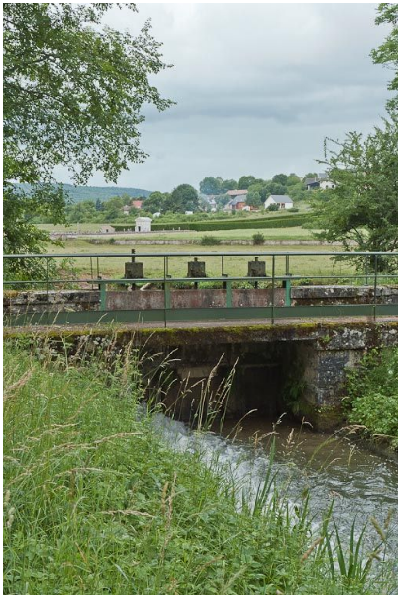
Vue des vannes de prise d'eau en amont de la rigole.
